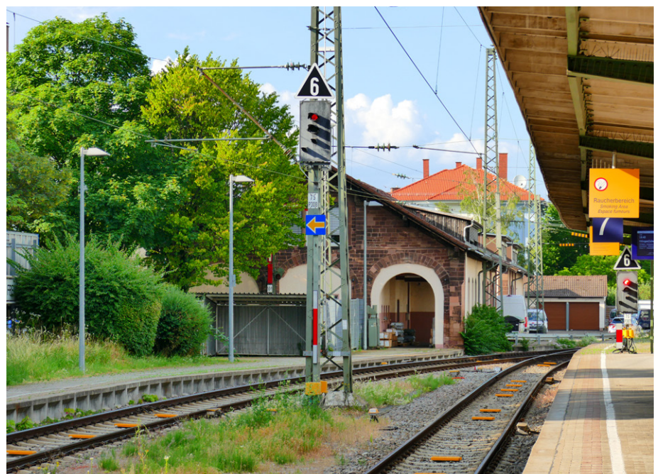
Abb. 3: ETCS-Ausrüstung im Bahnhof Freiburg im Jahr 2023
